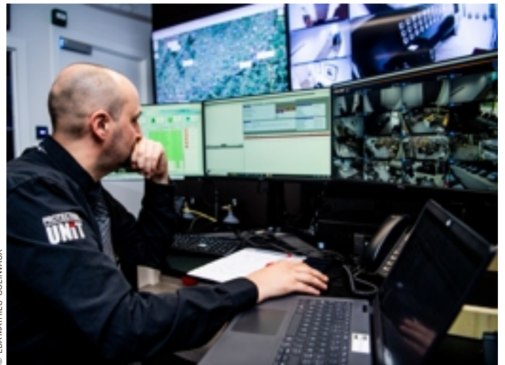
Depuis le « Bunker » de Limal, les agents se relaient pour surveiller des sites situés parfois à plusieurs centaines de kilomètres.
